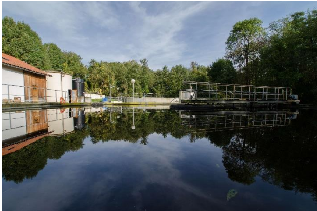
La station d'épuration du PIPA
